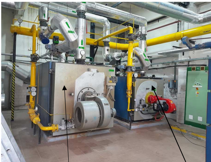
▲ Obrázok č. 2 Označenie kotlov v kotolni - kotol K1 je predmetom OTČ - kotol K2 nie je predmetom OTČ
