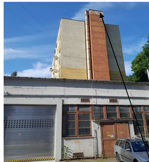
▲ Obrázok č. 3 Prefabrikovaný komín so samostatným vyvložkovým priechodom kotla K1
